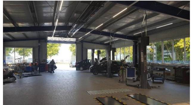
Installierte Dunkelstrahler im Werkstattbereich © Handwerkskammer Hannover
