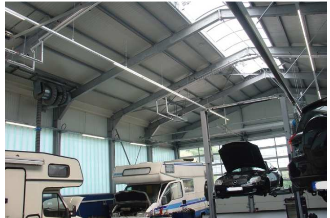
LED-Beleuchtung und Tageslichtnutzung © Saar-Lor-Lux Umweltzentrum GmbH
