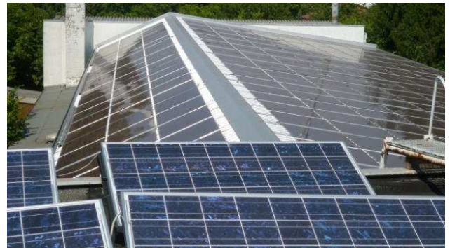
Photovoltaikanlage auf dem Werkstattdach © Saar-Lor-Lux Umweltzentrum GmbH
