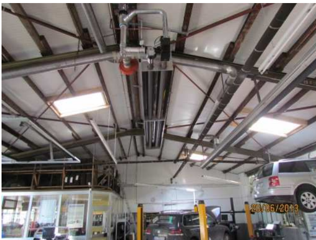
Innenansicht Werkstatthalle mit neuer Dachdämmung und Dunkelstrahler © Autohaus Wiaime
