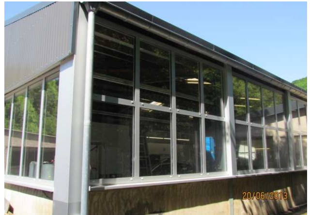
Fassadenfenster mit Wärmeschutzverglasung (Werkstatthalle) © Autohaus Wiaime
