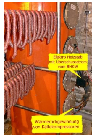
Pufferspeicher mit Wärmerückgewinnung und Heizpatrone © Handwerkskammer für Ostthüringen
