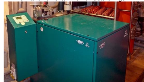
BHKW © Handwerkskammer für Ostthüringen
