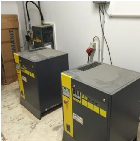
Kompressorenraum © Handwerkskammer Koblenz
