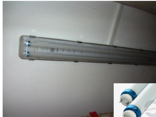
Eingebaute LED-Röhren © Handwerkskammer Koblenz
