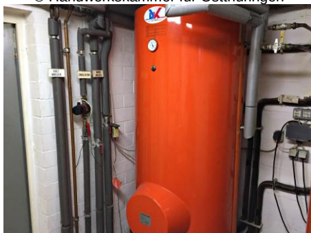
Pufferspeicher der Wärmerückgewinnung © Handwerkskammer für Ostthüringen
