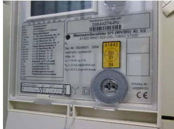
Stromzähler mit Lastgangmessung © Handwerkskammer Hannover
